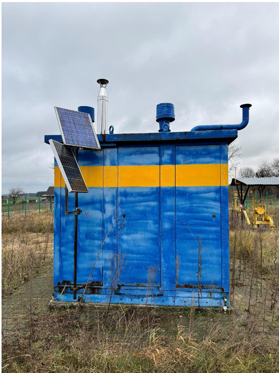
Zdjęcie nr 5 – Obudowa kontenerowa układów technologicznych stacji oraz kotłowni podgrzewu technologicznego.
